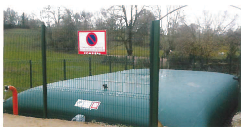
Citerne de défense incendie 120m 3 avec INC14 dans un lotissement
